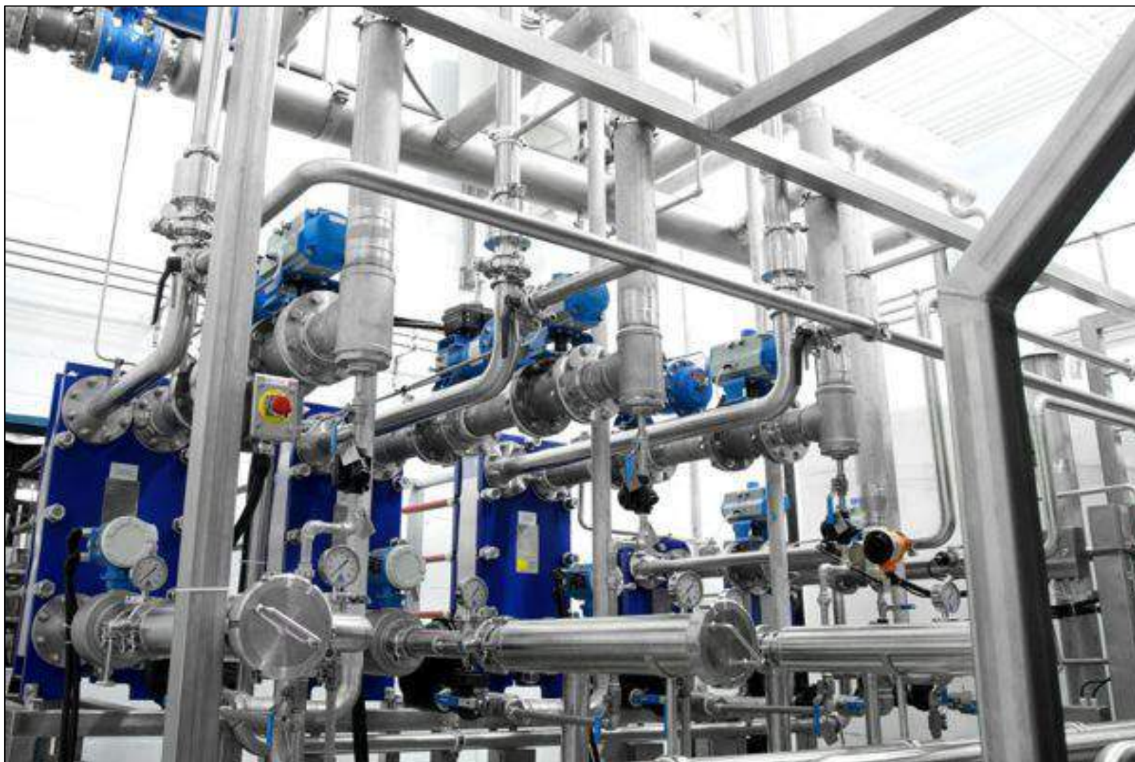
Sistema de tubulação em aço inoxidável
