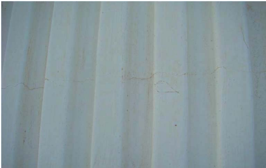
Figura 5 Fisuración antigua en los aplacados de fachada.
