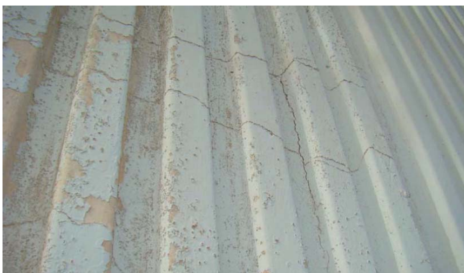
Figura 7 Fisuras horizontales de directriz recta.
